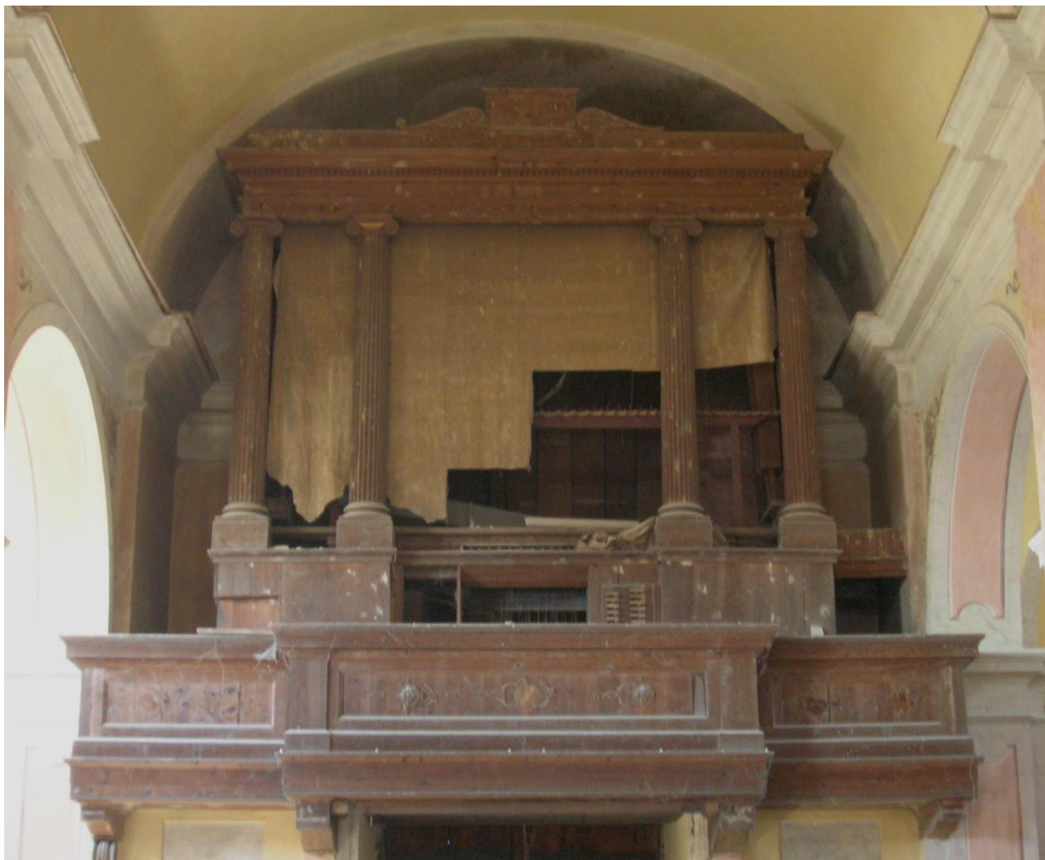
Organo prima dell'intervento
